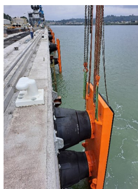
Zoom sur défense d'accostage et bollard, équipement pour l'accostage et l'amarrage des navires
